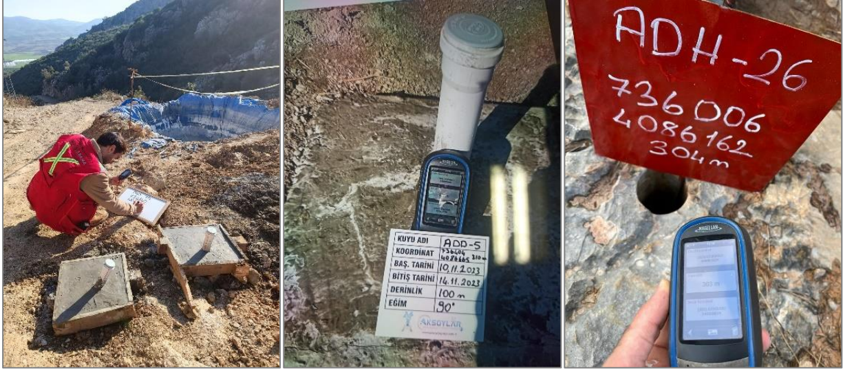
Şekil 72 Kuyu başı betonu, levhası ve etiketlemeleri.
